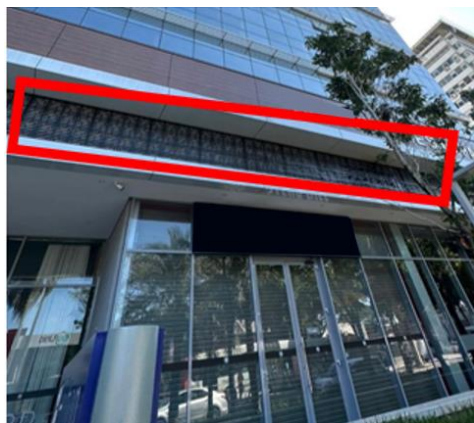
Figura 6 – Saídas de exaustão posicionadas para fachada e calçada no edifício B
