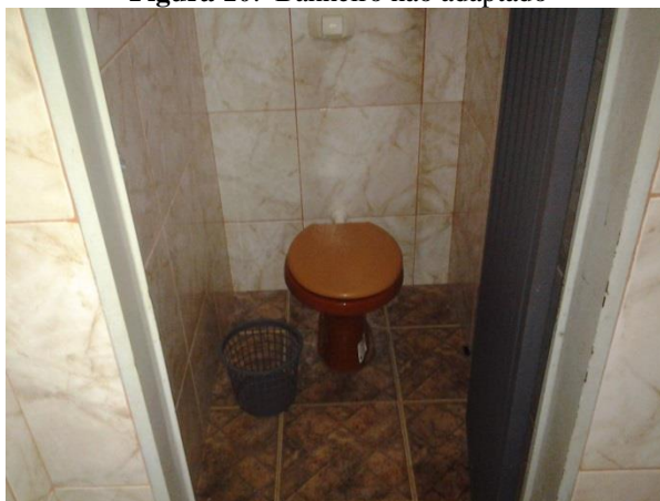
Figura 10: Banheiro não adaptado
